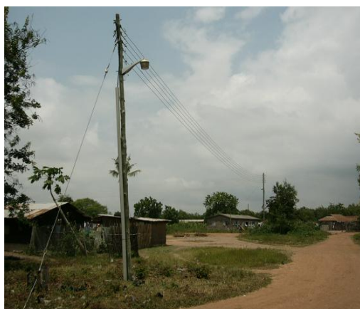
村内に設置された配電線(現在は機能せず)
