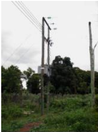
VRA-NED の 11/0.4kV 変電所
