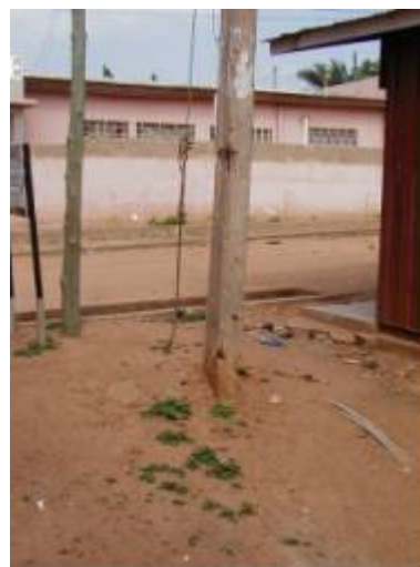
ECGの低圧配電コンクリート柱 （根元が壊れかかっている）
