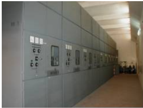
33kV 配電キュービクル 5 ckt
