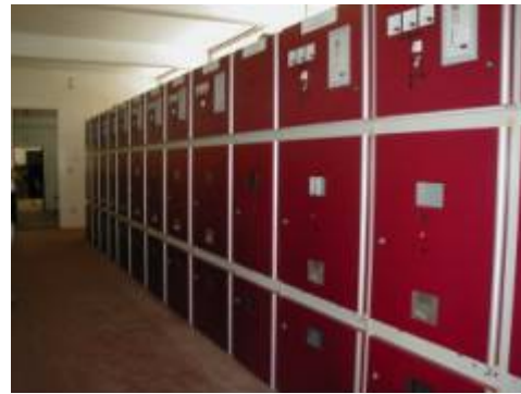
11kV キュービクル 10ckt
