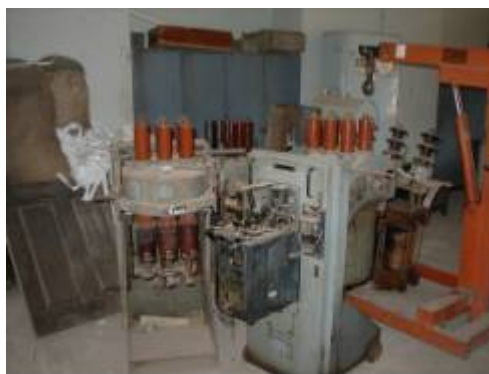
変電用訓練機材（時代遅れの機器）
