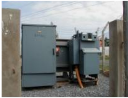
RMU とピラー及び変圧器
