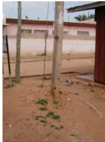
コン柱の根元が壊れかかっている
