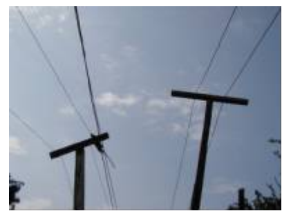
ケーブルによる不正接続線
