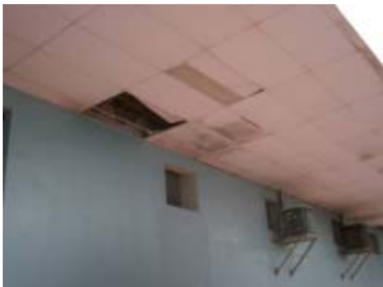
待合室には雨漏りがしており、不衛生な現状である。
