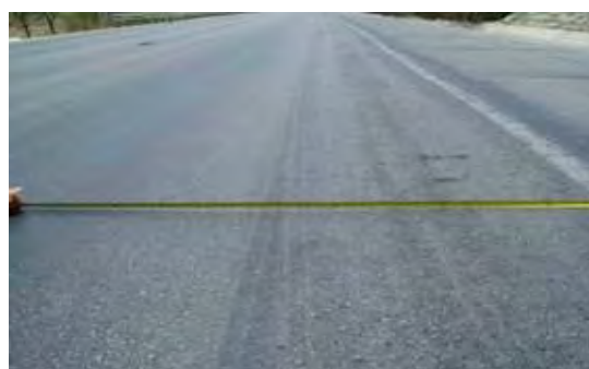
Rutting (Depth 15-20mm)
