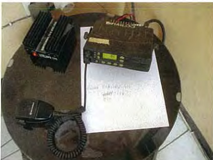
現在使用中の基地局
