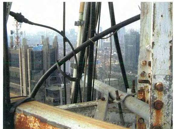
BEJ 空中線取付張り出しパイプ
