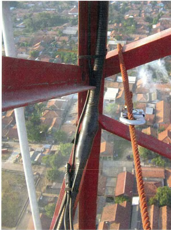
CIKARANG 受信同軸ケーブル変換部
