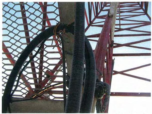
CIKARANG 受信同軸ケーブル 曲げ半径不良
