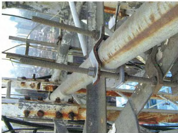
BEJ 空中線取付張り出しパイプ
