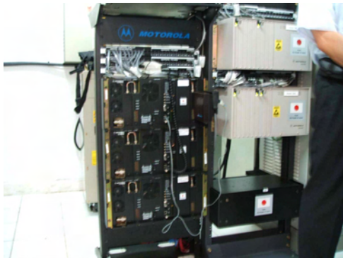
写真 8-1 電源が切られた中継機
