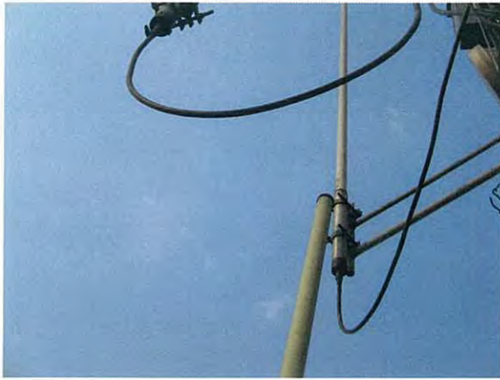
BEJ T3空中線11度傾き状況
