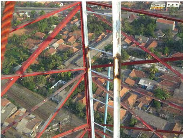
CIKARANG 階段発錆状況
