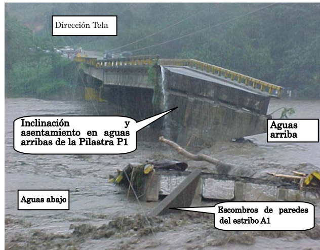
Foto 2.2.2-1 Estado de Daños del Puente Guaymón
