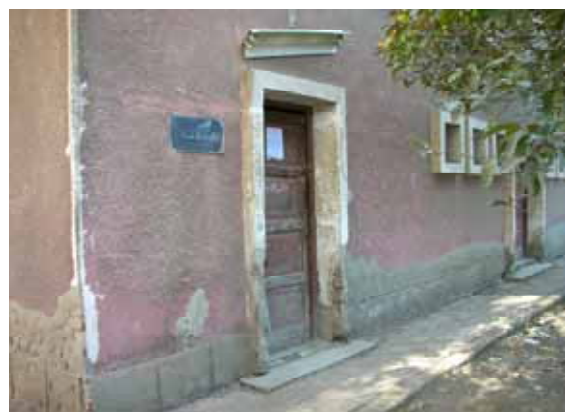
現ダマンフル農業機械化ステーション： 建物は小さく、築 40 年以上経過しており、壁が 剥がれ鉄筋がサビ、腐食で脆くなっている。
