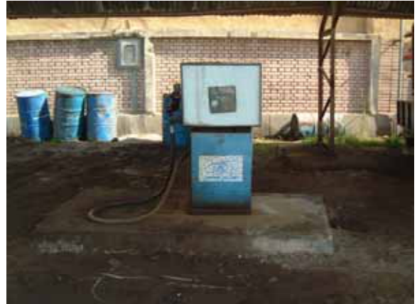
現ダマンフル農業機械化ステーション：唯一本計画に利用可能な給油施設である。直射日光で塗装が痛んでいるが機能に問題は無い。
