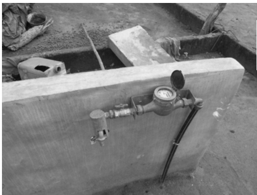
SONEB の戸別給水施設。この村の近くまで配 管されている。
