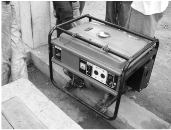
発電機 (14KVA)は 2 週間前から故障しており、井戸は使われていない。
