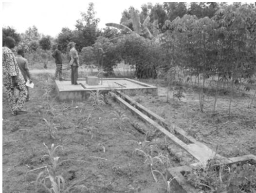
村の中心にある足踏みポンプ井戸。現在使用不能。
