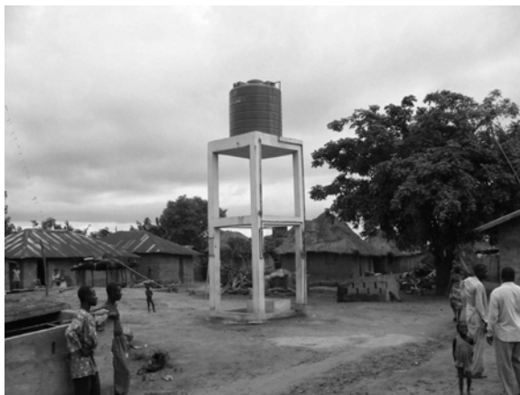
高架タワ：高さ約 6m、2m 3 のポリタンク
