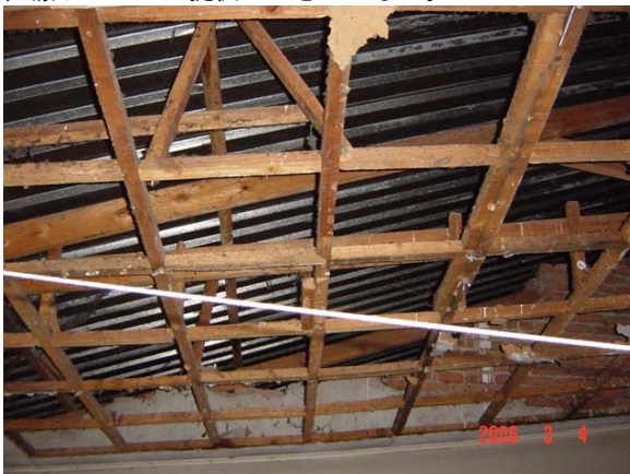
ムジンバ県エンフェニヘルスセンター 蝙蝠被害のため、天井を剥がした状態。
