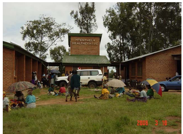
リロングウェ県ムバンゴンベ1ヘルスセンター 小屋組みの木材がシロアリのためぼろぼろになってい る。シロアリを駆除し小屋組みの補強をしないと、屋 根が壊れる恐れがある。
