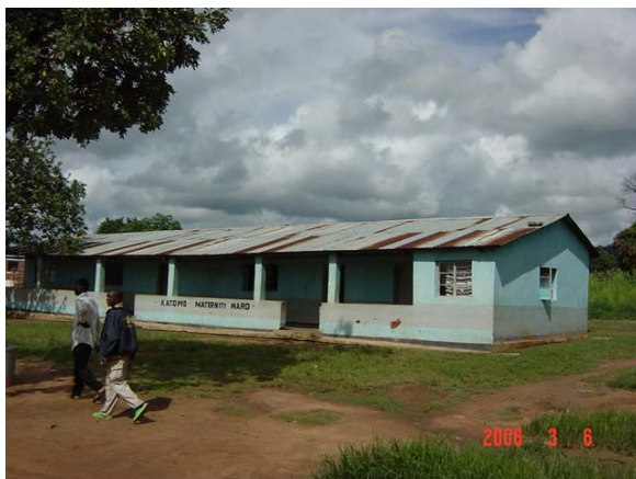
ルンビ県カトローラルホスピタル 産科棟外観(1957年築)。屋根の波板鉄板が錆びているが、ペイント塗装のメンテナンスが行われていない。
