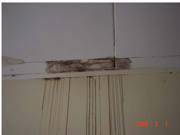
ルンビ県チティンバヘルスセンター 屋根裏に進入した蝙蝠の糞尿のため、部屋は悪臭がし、天井及び壁が汚れている。
