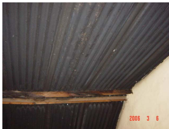
ルンビ県カトローラルホスピタル 産科棟の屋根裏。母屋材が細く、構造的に弱く、人が屋根にあがると壊れる恐れがある。
