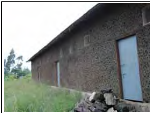
建設中だが、既に傾いている壁と扉 東アルシ県ハムレ 19 小学校（8 学年）
