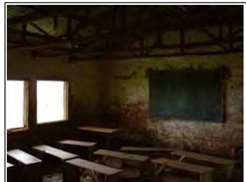
築 10 年程だが、すでに老朽化した教室の内部 西ハレルゲ県オダロワ小学校（8 学年）
