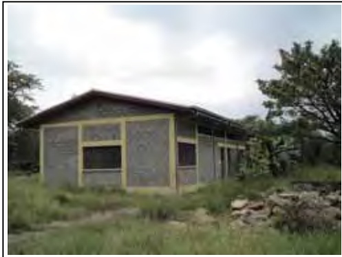
外壁は表面仕上げ無し、柱・梁は塗装仕上げ 西ハレルゲ県バデッサ小学校（8 学年）
