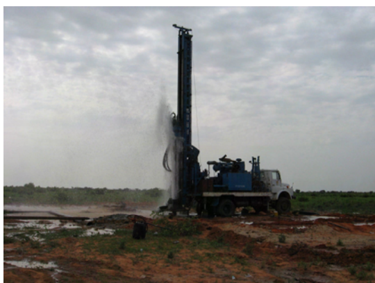
民間業者による Damaturu 市近郊での深井戸掘削地点。井戸洗浄中(エアリフト)。井戸深度 150m。
