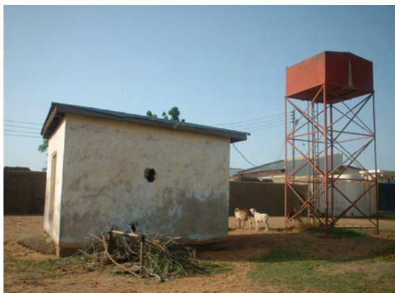
村落部における公共水栓給水施設の水源井戸と高架タンク (Yusufari LGA の Mai Malari 村)。LGA が維持管理を担当している。
