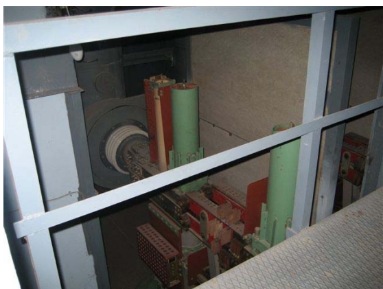
発電機遮断機（1相分）
