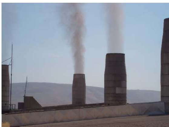
石炭ミル排気用煙突（集塵機機能劣化）
