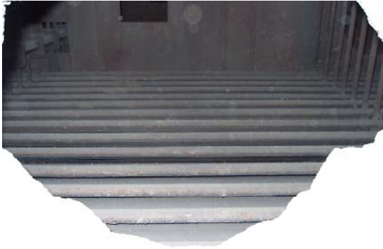
No. 2 ユニットボイラ内部（過熱器）長期間停止しているが、チューブ表面汚れている。
