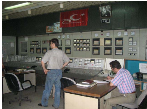
中央制御室操作盤（1）
