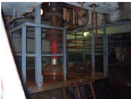
冷却水ポンプ (グランドからの水漏れが激しい)
