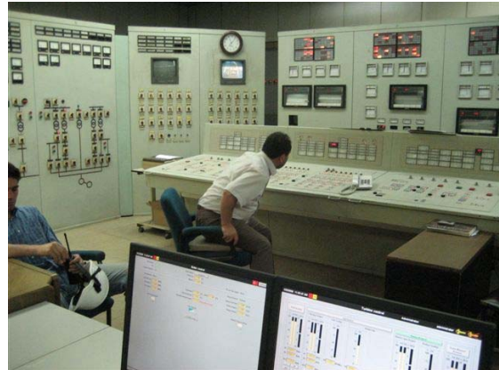
中央制御盤（ボイラデスク盤側）
