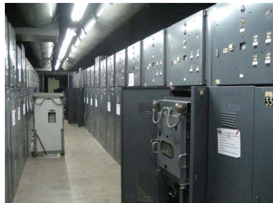
高圧電源盤（ロシア Elektro Sila 社製）
