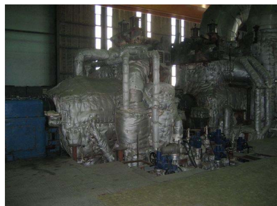
高圧タービン (手前)、中圧タービン (油圧 [サーボ系統改造後の確認中でタービンカバー外し])
