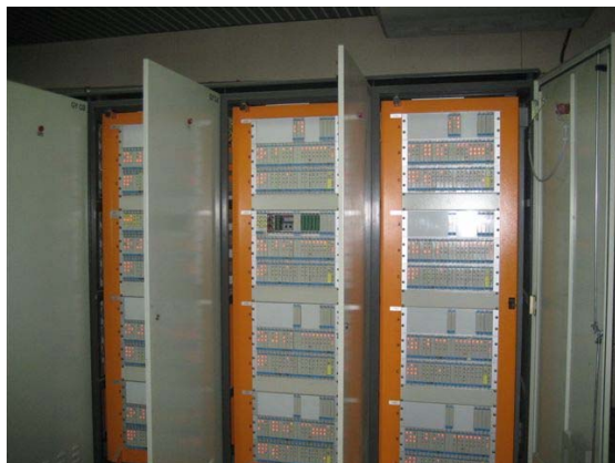
自動バーナ制御装置（Siemens 製）
