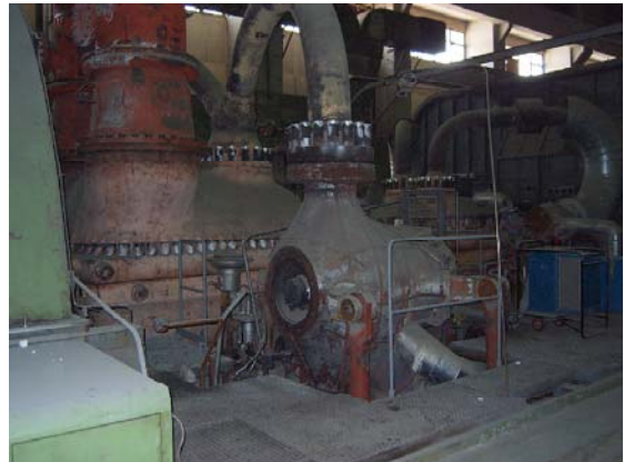
No. 2 ユニットタービン
