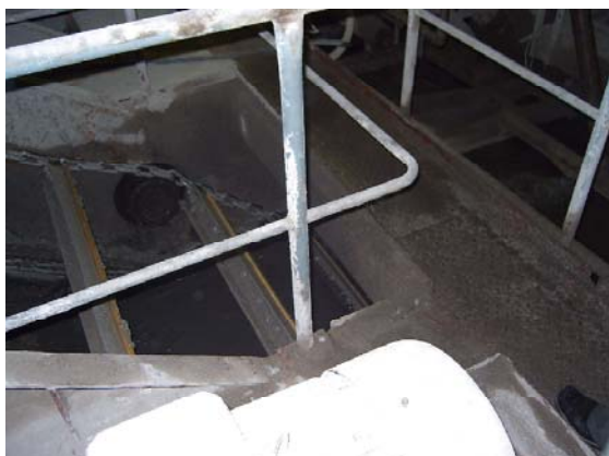
ボイラ Ash 搬送用チェーンコンベア (Ash の粒径が細かく搬送できない)
