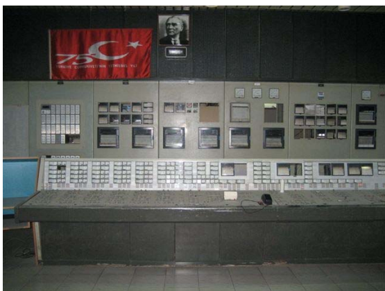
中央制御室操作盤（2）
