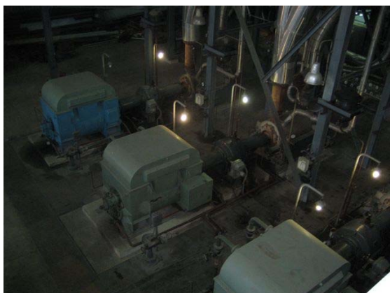
給水ポンプ・モーター (3台)
