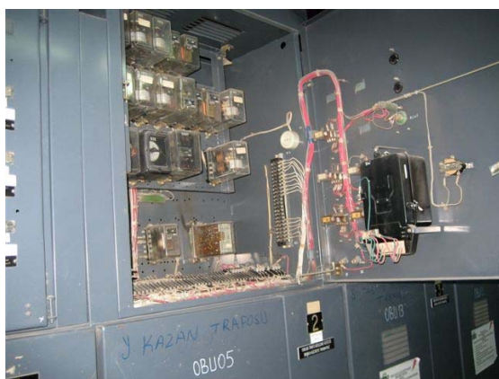
所内電源フィーダ保護リレー （ロシア Elektro Sila 社製）
