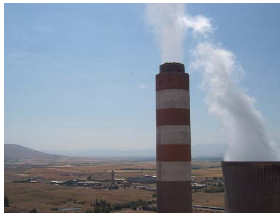
ボイラ煙突（上部が損傷している。 内部も腐食の可能性あり）
