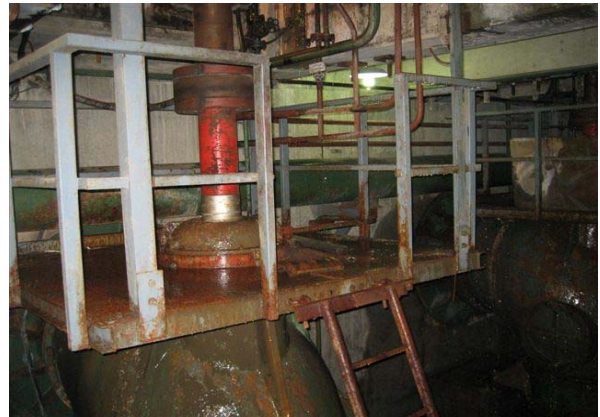
復水器及び循環水ポンプ
