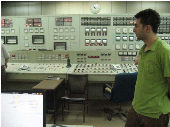
中央制御盤（左半分／ボイラ：右半分／タービン） 設計思想が全く異なる盤の組み合わせ
