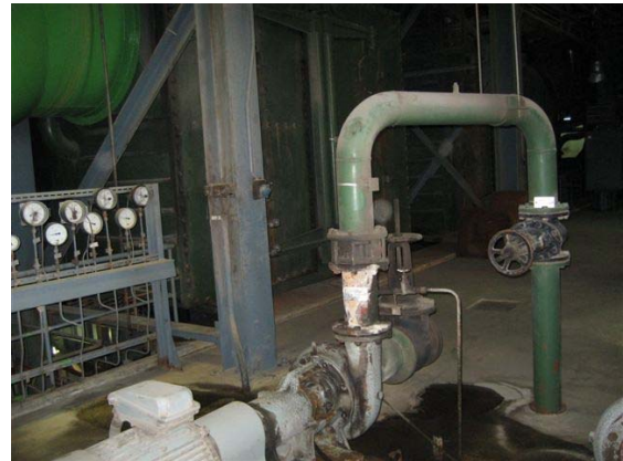
タービン建家現場計器 (左端)
