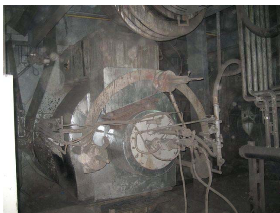
ボイラバーナー部
