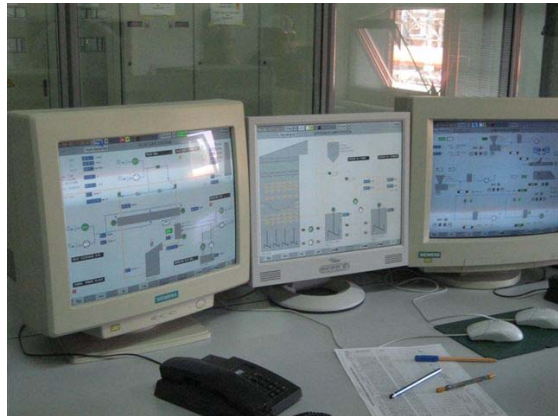
脱硫装置監視制御モニター
