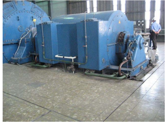
発電機（奥）と励磁用交流発電機（手前）
