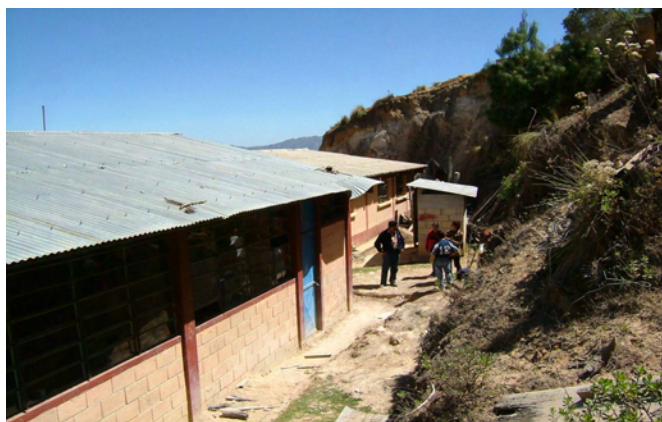
2.校舎後部、屋根、窓ガラスの一部破損、(後背部斜面崩壊の危険あり)
