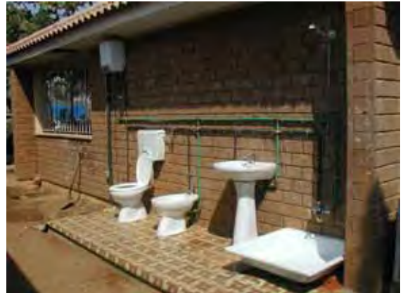
36.キランビセンター（配管）
