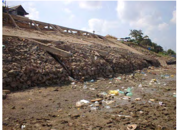
写真 3.2.3 オールドマーケット東護岸の崩壊状況(2)
