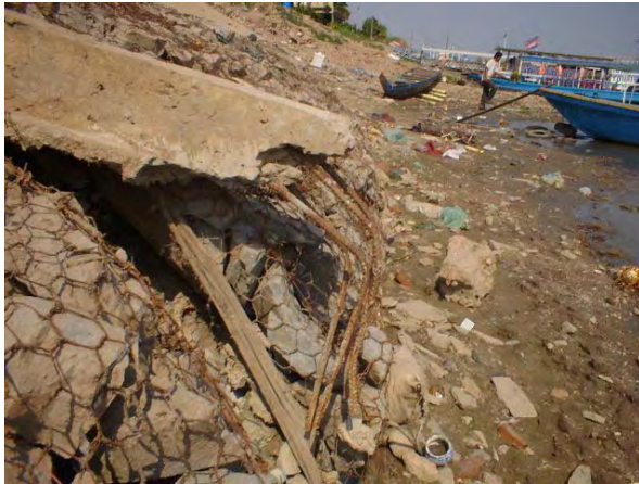
写真 3.2.2 オールドマーケット東護岸の崩壊状況(1)
