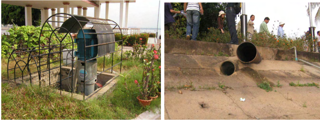
写真 2.1.1 チャトムック国立劇場敷地内の既設ポンプおよびその排水口の現況
