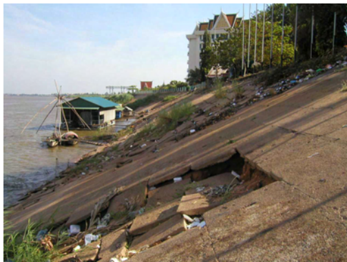
写真 1.1.2 法面コンクリートが崩落した護岸の様子(ヒマワリホテル直上流)
