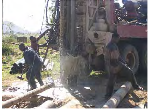
掘削により確認された地下水
