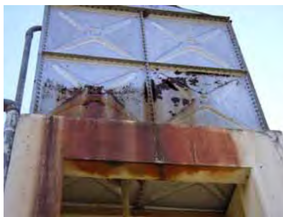
給水タンクの腐食
