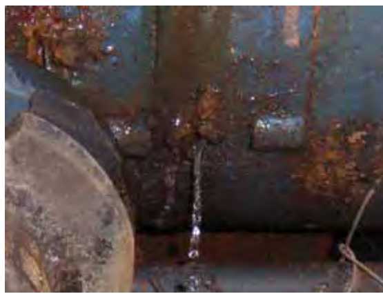
ポンプ本体からの漏水
