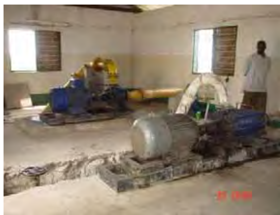
揚水ポンプの故障
