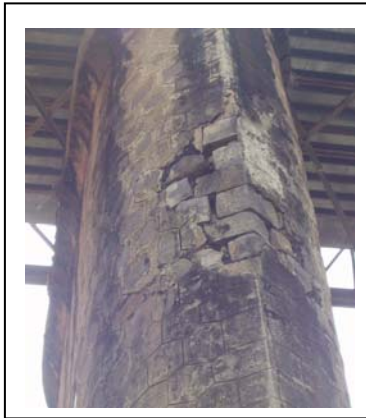
写真-7：既設橋梁 P2 橋脚の石積みモルタルの剥がれ等、損傷が著しい。
