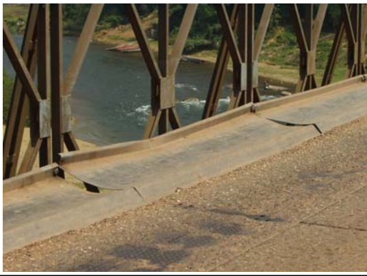
写真-3：既設橋梁歩道部のボルトの欠落、床版の曲がり等の損傷（歩行者の通行不能）
