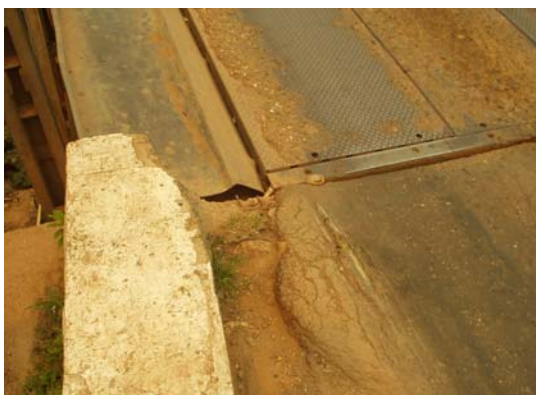
写真-5：既設橋梁と取付道路との段差により車両通行時に騒音が発生し苦情が出ている。
