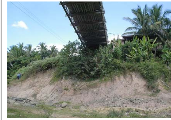
写真-9：既設橋梁左岸側橋台前面が河川流により侵食を受けている状況。
