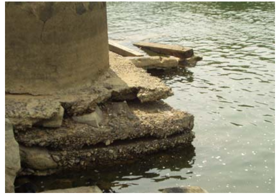
写真-8：既設橋梁の P3 橋脚基礎部分が洗掘により損傷を受けている。
