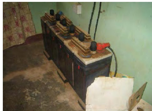
シサラ東郡 ウェンベレ保健所、 無線機用バッテリー：太陽電池による蓄電方式
