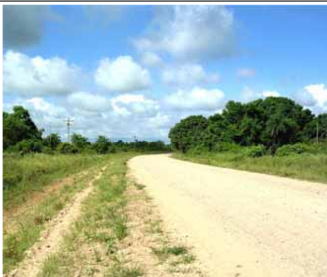
【サンタクルス県】 整備1カ月後の地方道路路面状態(走行性良い)
