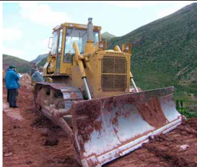
【ポトシ県】 日本の供与ブルドーザを使用して の地方道路拡充現場
