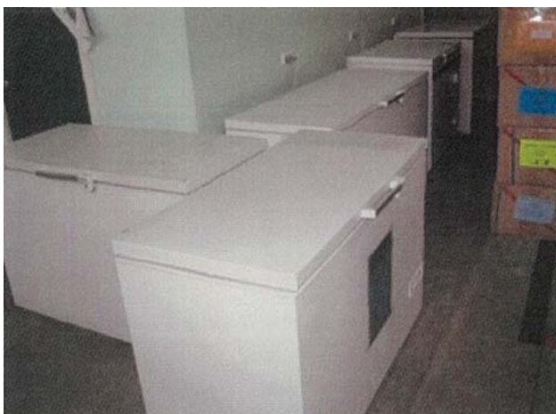
写真5 州ワクチン倉庫で使用されているAusAID供与の電気式アイスライン冷蔵庫と冷凍庫。5年間で冷蔵庫は合計15台、冷凍庫は20台要請されている。
