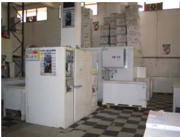
サナア市内の中央倉庫にはコールドルームが7室、フリーズルームが3室設置されている
