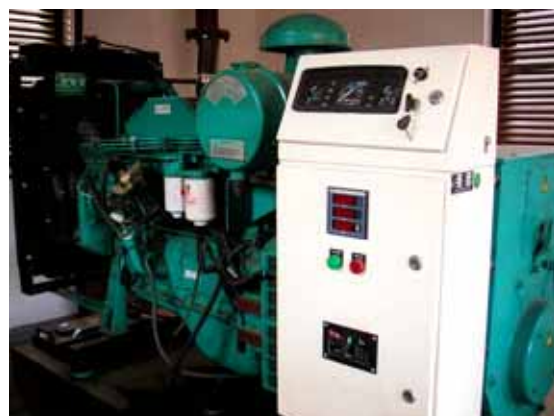
写真11 停電に備えて中央倉庫に設置してある、自動切替の発電機である。
