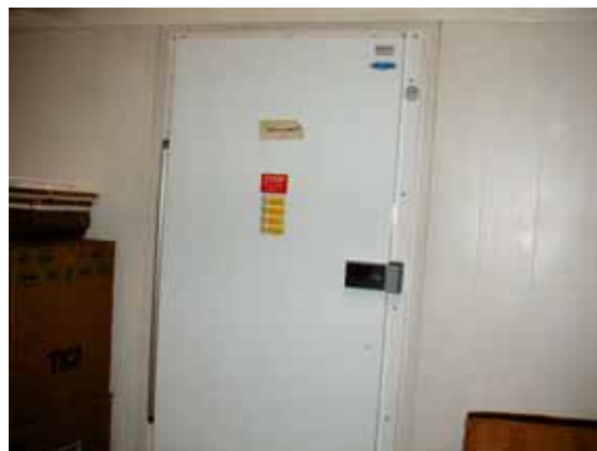
写真8 1995年にわが国が供与した中央倉庫のワクチン用冷蔵庫で、扉右上方にJICAステッカーが貼付してある。
