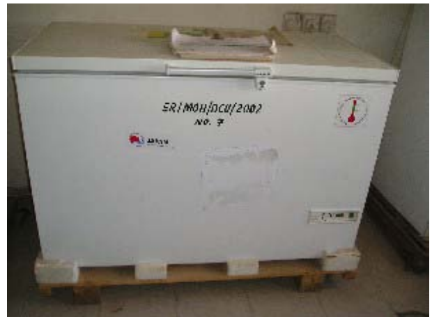
写真6 イースタン州倉庫の冷蔵庫。ワクチン保存用に有効に使われており、温度管理もきちんとなされていた。ステッカーが貼付してある。
