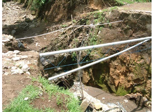
アルデア・カシャケ橋：2連式アーチ型カルバートであり、洪水時に流木などの流下物によって閉塞され、流水圧により、倒壊流出した。
