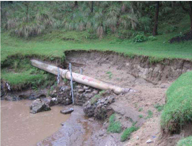
サンイシドロ給水システム主要導水管 R-3:河岸侵食で土砂流出、管路損傷した。仮復旧済み。
