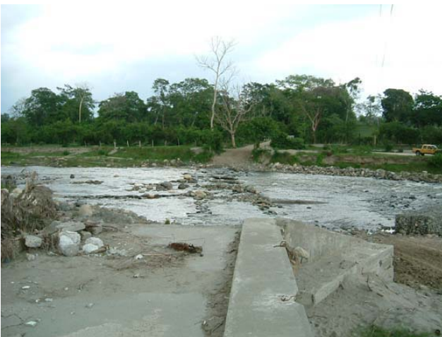
ソブレ・リオ・カブス橋：洪水によって流木などの流下物による橋梁の閉塞、洪水流の橋台背後への回りこみにより橋台が洗掘・転倒流失した。
