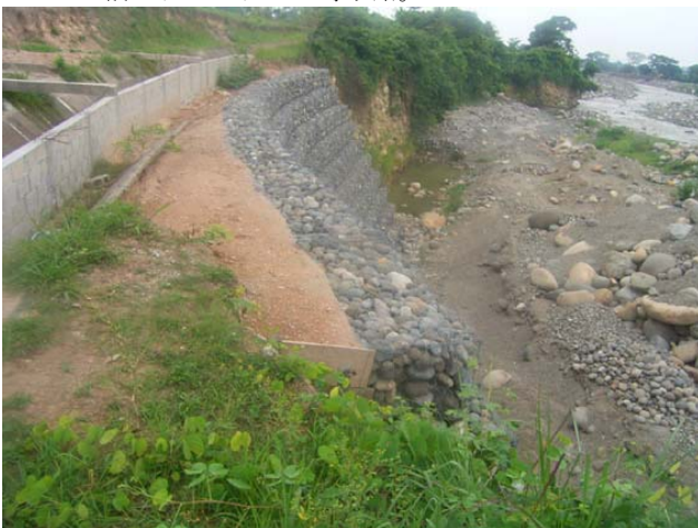
カタリナ導水路の地盤流出。すでに護岸（蛇籠）が設置されているが、上下流側の追加護岸が必要。
