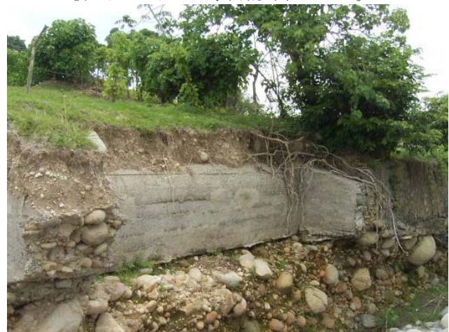
スタンによる洪水で洗掘されたカタリナ導水路の露出した暗渠。
