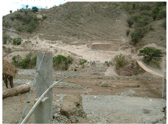
サンタ・ローサ橋：洪水による橋台(左岸)の洗掘・流出、それに伴う桁および橋脚が落下・転倒流出した。右岸橋台を除き痕跡はない。
