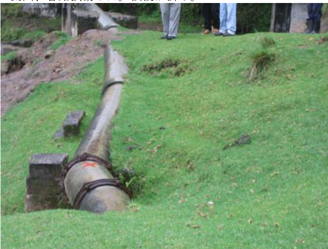
サンイシドロ給水システム主要導水管 R-4:土砂崩れにより管路が蛇行、継ぎ手損傷した。仮復旧済み。
