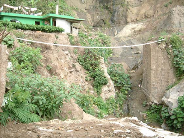
アルデア・ラス・バランカス橋：洪水によって完全に橋台の洗掘・流出した。
