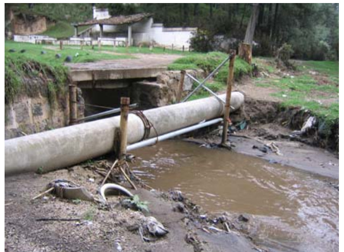
サンイシドロ給水システム主要導水管 R-1:洪水圧で損傷した。仮復旧済み。
