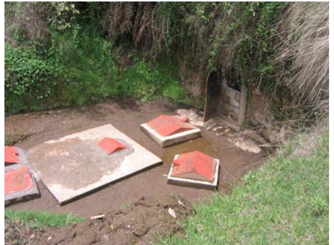
モリノビエホ湧水源 N-10:冠水し、土砂に埋もれた。
