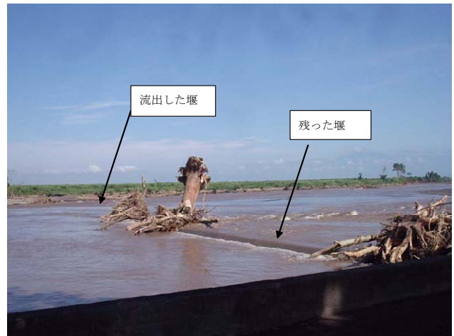
ラ・ブランカ左岸側から右岸を見たもの（途中から右岸までの堰が完全に流失している）。
