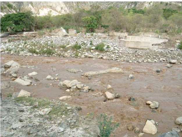
サン・ファン橋：右岸橋台を除き旧橋の痕跡はない。橋梁地点は急流部の曲線部分にあり、河流攻撃部の左岸が流水圧に抗しきれず、左岸橋台が流出し、桁および橋脚が転倒・破壊・流出した。
