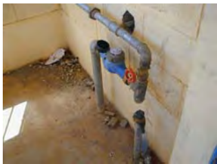
10 : 公共水栓 内部 破損バルブ
