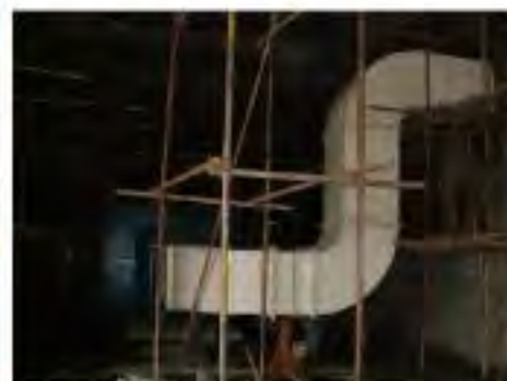
4集塵脱臭装置ダクト
