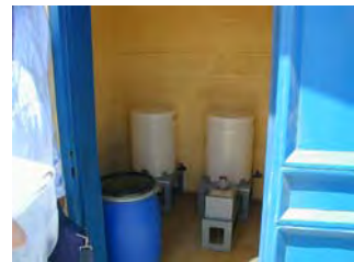
6 : 送水ポンプ場滅菌装置
