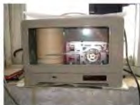
1.2雨量計(測定器)
