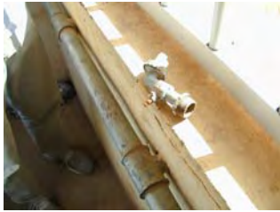
13：公共水栓及び配管状況 極端に管路が外壁に接している
