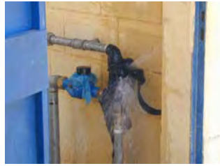
14：公共水栓 破損バルブ 水漏れ
