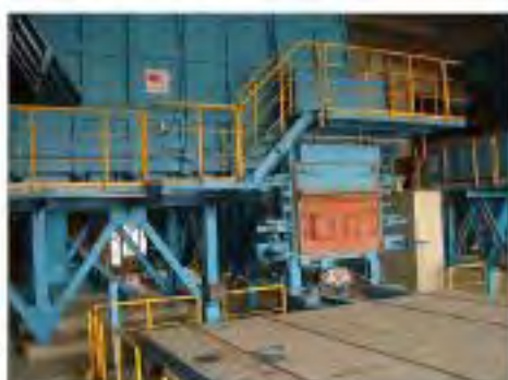
3圧縮設備全景2
