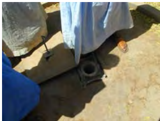
19：修理中ハンドポンプ跡
