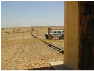
4 : 揚水ポンプ場・導水管路
