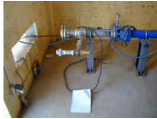
2 : 揚水ポンプ場 F-5
