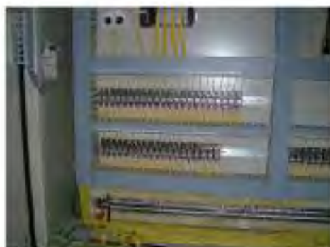
3.6電気計装設備
