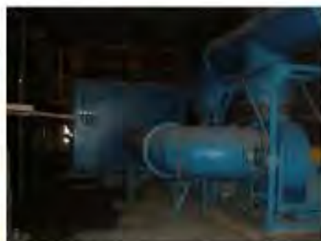
4集塵脱臭装置
