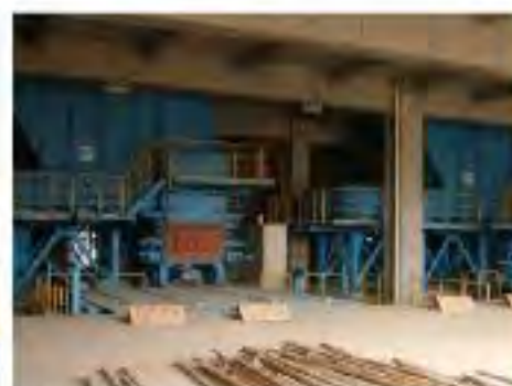
3圧縮設備全景1
