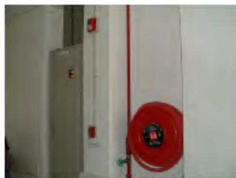
8.外来待合室消火栓と電気パネル
