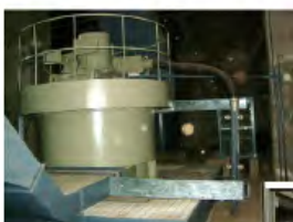
15. ダクト部、保護・ 遮断版(2ヶ所)
