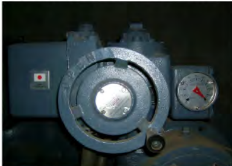
7. 同上 修復後フル稼働中の主ポンプ(右端：ゲージ)
