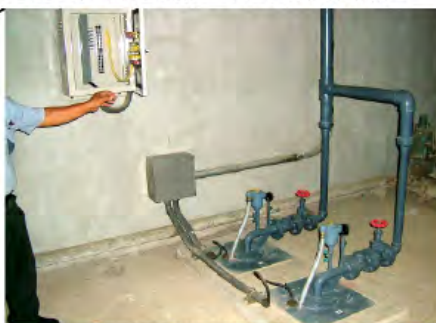
11. 同上 封水ポンプ及び操作盤 (更新) 後部壁面は、漏水対策処理後塗装済み
