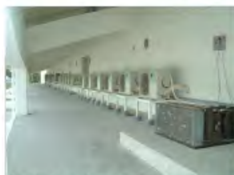
22.空調機屋外ユニット
