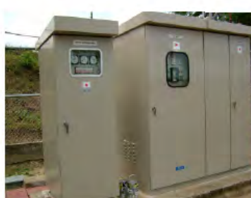
15. 同左 引き込み 受電盤設備点検後 再塗装済み
