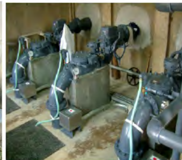
13. 同左機場内、水中ポンプ(3基)及び専用バルブ：更新後フル稼働中
