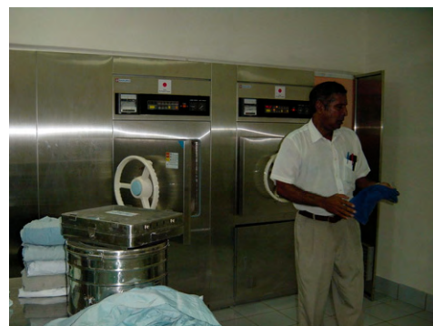
46. 高圧蒸気滅菌装置
