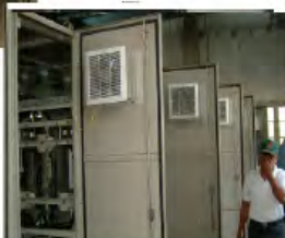
16. ポンプ操作パネルボックス裏側 換気扇(4ヶ所)
