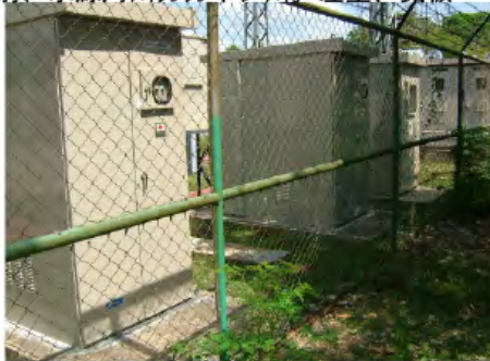
4. 受変電設備 更新
