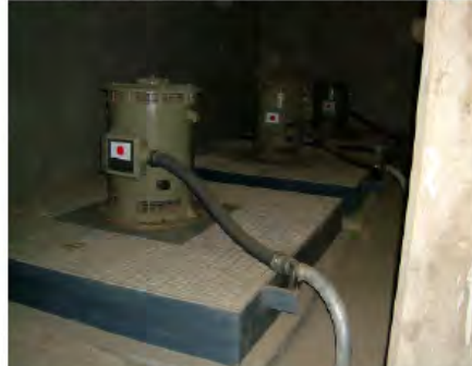
5. 同左モーター。オーバーホール後フル稼働中
