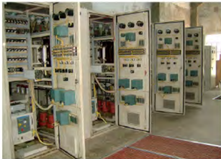
8. ポンプ操作パネル盤(ポンプ4基)、点検一部更新
