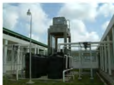
19.雨水用受水槽・高架水槽
