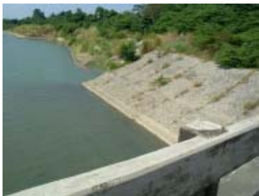
橋脚下部の不十分な護岸
