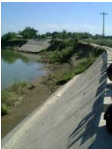
パンパンガ川の根崩れしそうな護岸
