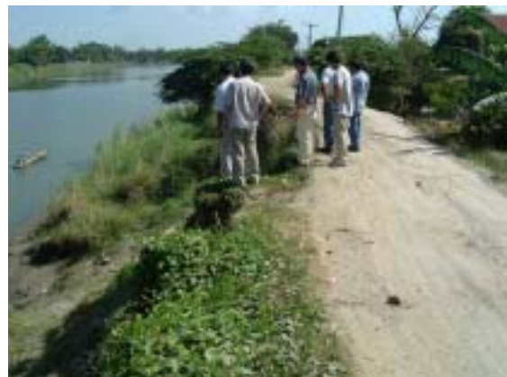
浸食され、決壊の危険がある土手
