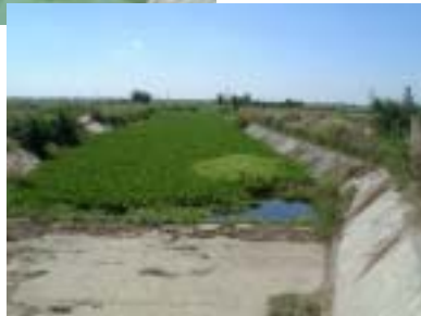
市街地から自然流下で水がはけない。 排水路が埋まり、ポンプ場が機能していない。
