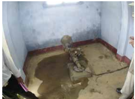
K3-1 Dak Ui JICA 井戸ポンプ
