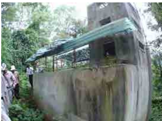
K3-1 Dak Ui JICA エアレーション塔、ろ過池
