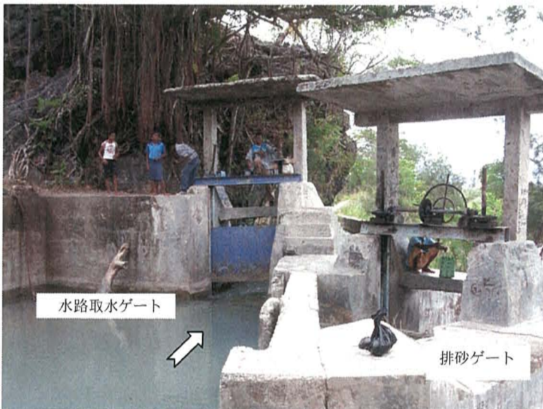
沈砂池および幹線水路取水工ゲート：
