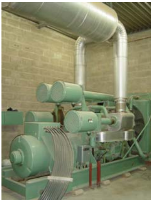
APLACO予備電源用ディーゼル発電機
