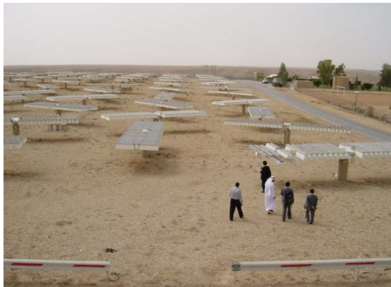
KACST Solar Village PV 350kWpのサイト
