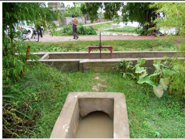
写真4：ハイズン省ナムザック県（ポンプ灌漑） 二次水路（ライニング）～三次水路
