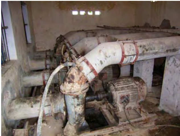
写真1：ハイズン省ナムザック県（ポンプ灌漑） ポンプ場内
