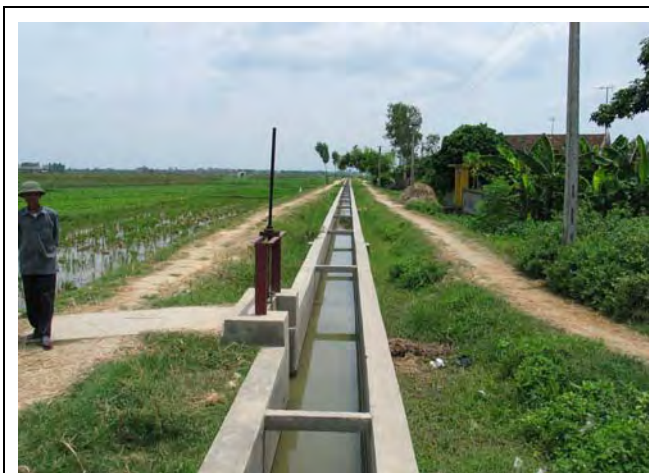
写真7：ハイズン省 ジアロック県（ポンプ灌漑） 二次水路（ライニング）
