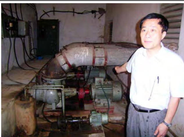
写真5：ハイズン省ジアロック県（ポンプ灌漑） ポンプ場内
