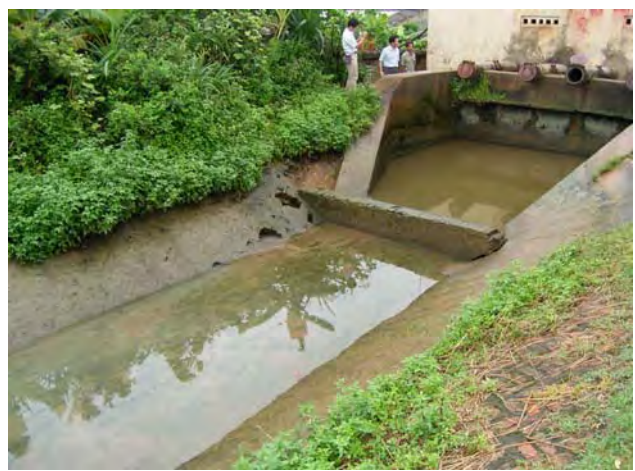
写真2：ハイズン省ナムザック県（ポンプ灌漑） ポンプ場吐口
