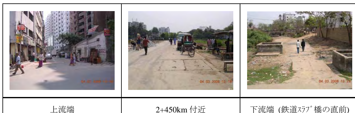
写真 3.3 セグンバギチャ水路のボックスカルバート区間の現況
