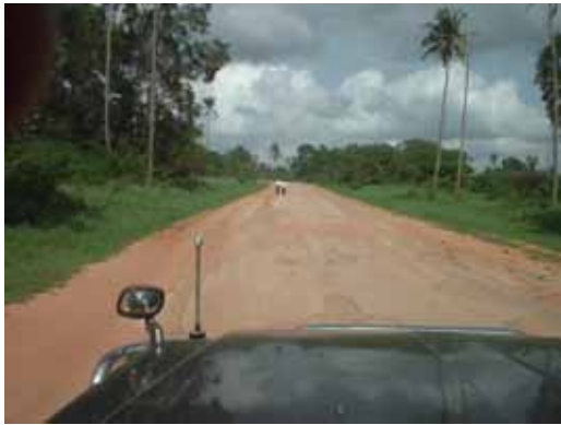
ブングとキビティ間の舗装の劣化
