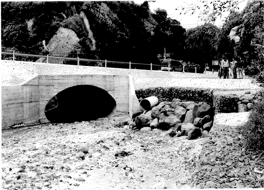
ハリケーン「ミッチ」後、応急復旧した道路。河床の上昇が著しく、この程度のコルゲート管では埋没し、道路盛土を破壊するおそれがある (Guatemala市西部 Rio Mansilla)
