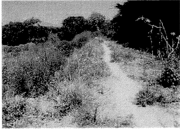
Lempa川下流域の右岸側には日本の見返り資金を利用して7.5kmにわたって堤防が築かれている。これは、今後17.5kmに延長され、左岸側にも16.8kmの築堤が計画されている。
