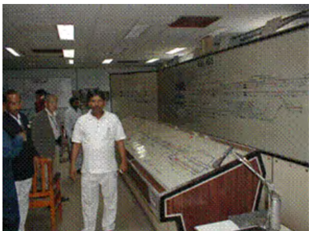
別添資料 図 7- 60 駅コントロール室 (東回廊の Mughalsarai JN)
