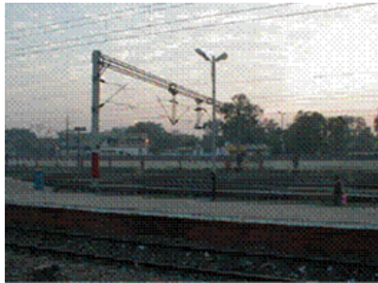
別添資料 図 7- 39 電車線路設備 写真
