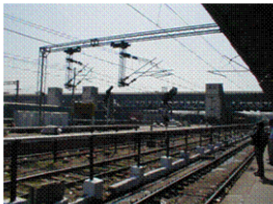
別添資料 図 7- 41 電車線路設備 写真
