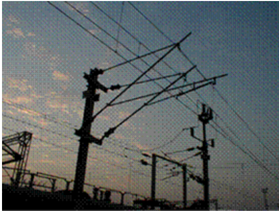
別添資料 図 7- 38 電車線路設備 写真
