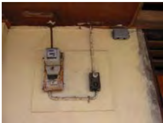
積算電力計と引き込み遮断機。右上は電話の 引き込み保安器
