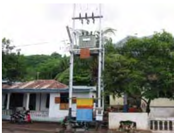
計画サイト前面道路反対側の架空送電線と柱 上変圧器。電力引き込みはここから可能である
