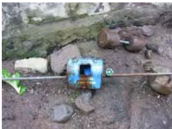
市水量水器（水道メーター） 引き込み配管が露出したままである
