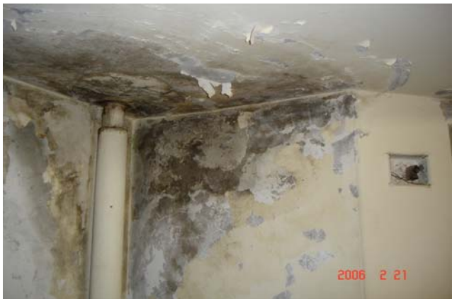
築30年で排水管の漏水や湿気によりペンキ剥離がある
