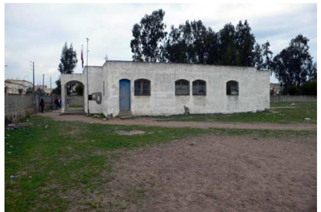
築20年経過した施設はクラックやモルタルの剥離がある
