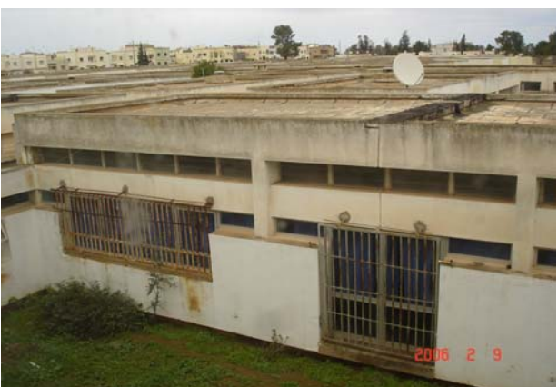
広大な病院の全域で雨漏りがある(本計画の接続部分)
