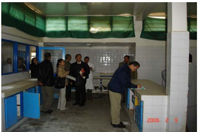
産科部門の一部は雨漏りと降込みが激しい
