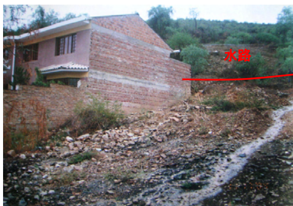
水路からの漏水状況
