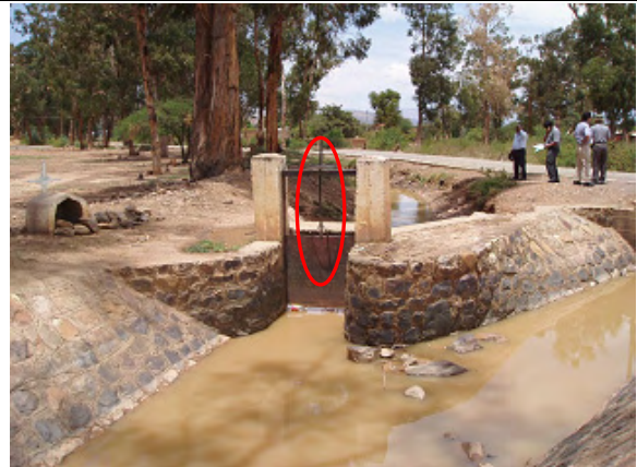
分水ゲートの現況 (スピンドル部分が歪み、開閉操作が困難)
