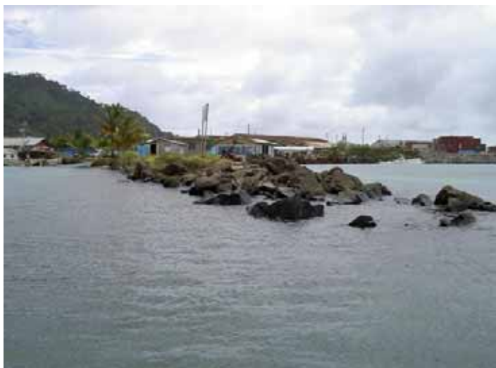
写真 - 12 北港護岸(小型船係留施設)計画地点 捨石が流出し、堤体の存続危ぶまれる。
