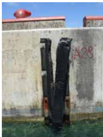
A 岸壁 防舷材
