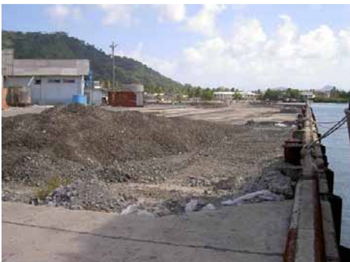
写真 - 3 ウエノ港 旧 B 岸壁区間 FEMA 工事施工状況(路床工まで) 2006 年 2 月現地調査時点。
