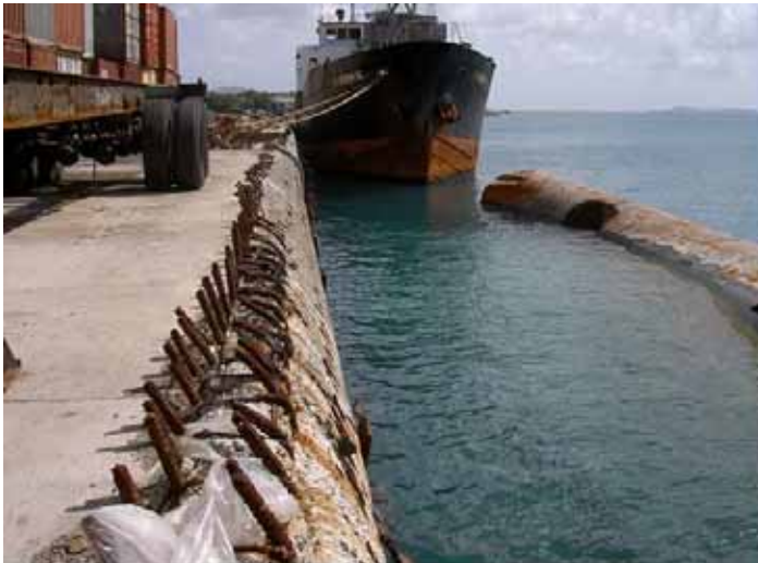
写真 - 2 ウエノ港 拡張 B 岸壁区間 上部工及び車止めの損傷状況及び 転覆した沈船(約 870 重量ト)。
