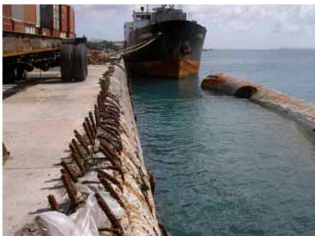
写真 3.2.2-1 B 岸壁上部工及び車止め現況(連結筋を残し、車止めは全数流出)
