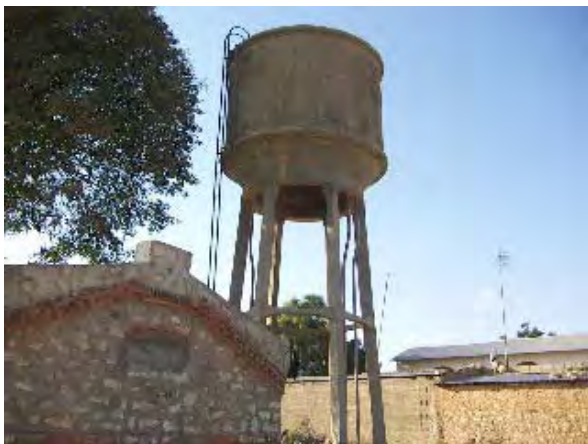
写真-9：既存配水池（アディケイ市）老朽化が激しく、周囲の数戸と給水車への給水のみで使用されている。
