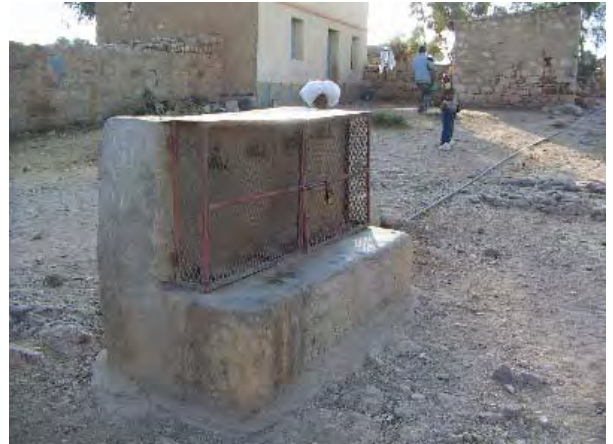
写真-10：使用されなくなった公共水栓（アディケイ市）配水管の破損により現在は使用されていない。
