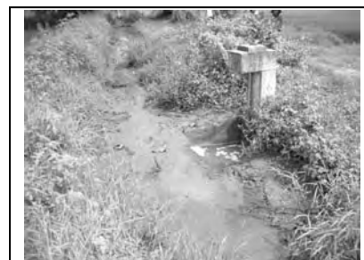
滞砂と雑草で流れが阻害されているトラクト2地区のD-水路 (ラジャンガナ・スキーム)
