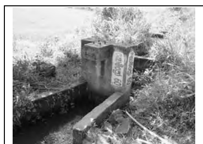
ゲートがなくなった分水路 (ナチャドゥワ大規模灌漑地区)
