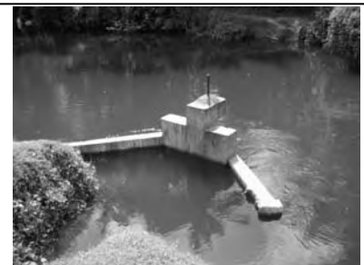
過大な流量と水路の侵食のため水中に没した幹線水路からD-水路への分水工 (ラジャンガナ大規模灌漑地区)
