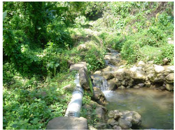
コングライ湧水の取水地点から送水ポンプ場までの管路。
