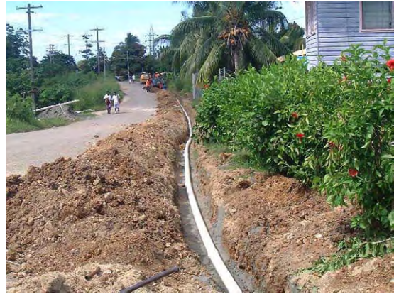
Vavaya Ridge 地区での管路敷設替え工事のようす。1 区間約 100m の敷設替えを行った。
