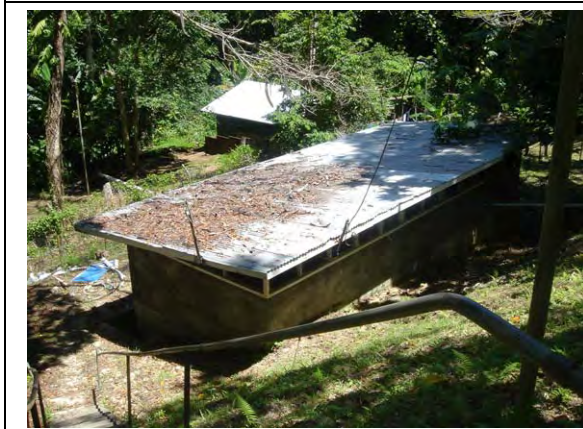
ロベ湧水から少し下流にある塩素注入建屋。
