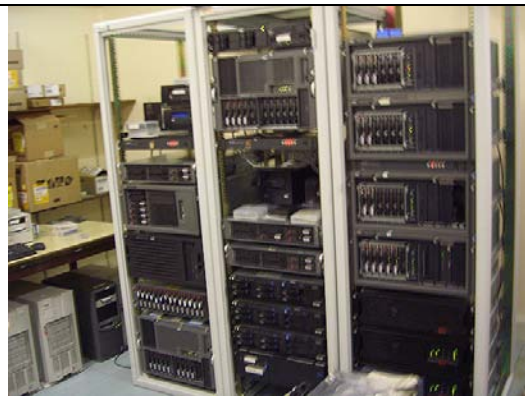
手狭なサーバー室
