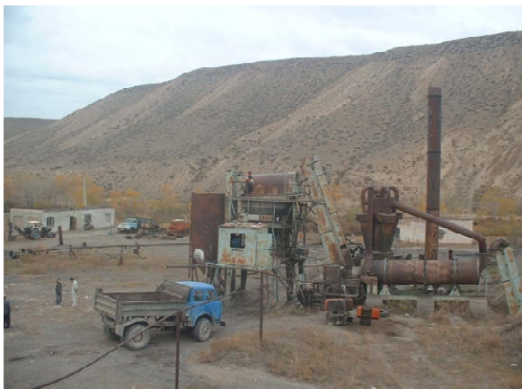
ナリン州内のビシュケク～ナリン～トルガルト道路沿線で唯一稼働する323km地点のアスファルトプラント(隣接して骨材プラント有り)。生産能力約10t/hと低い。
