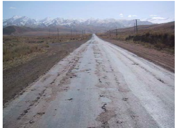
本計画で舗装打換え作業が必要と判断された270km付近の道路状況: 舗装の凍上(持上がり)が多数見られ舗装構造に関する破損が進行
