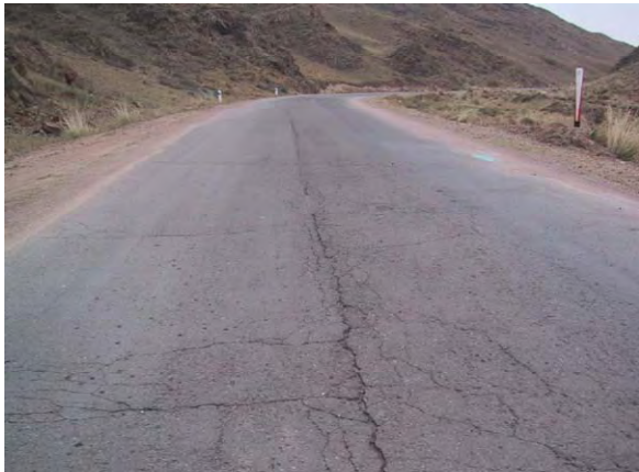
本計画で舗装打換え作業が必要と判断されたクワイク峠(10km付近)の道路状況: 路面に網状ひび割れが多数発生し舗装構造に関する破損が進行
