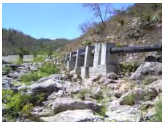
Tubería de Conducción en el sitio de Presa Derivadora de Ojojona
