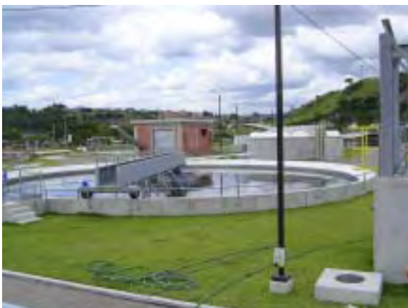
Planta de Tratamiento de Aguas Negras Finalizada (Asistencia Italiana)
