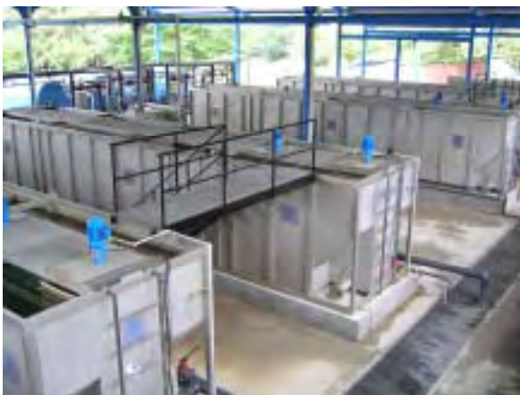
Planta Compacta: Ampliación de la Planta de Tratamiento Los Laureles (España)
