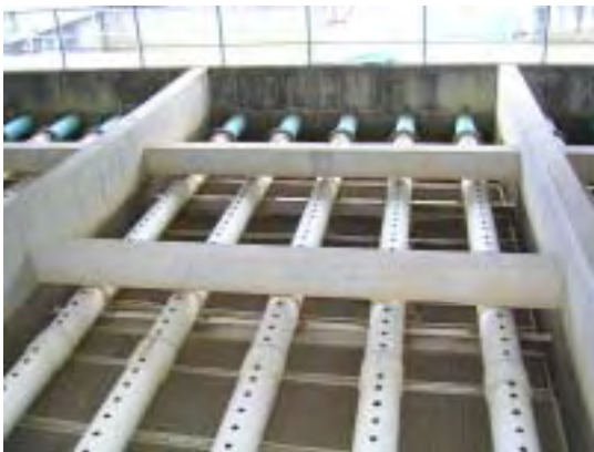
Planta de Tratamiento Picacho (tanque de coagulación)
