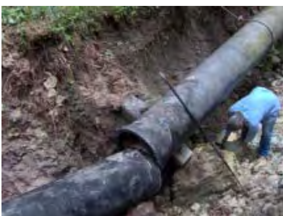
Daños en la Tubería de la Línea 22 (proporcionada por SANAA)
