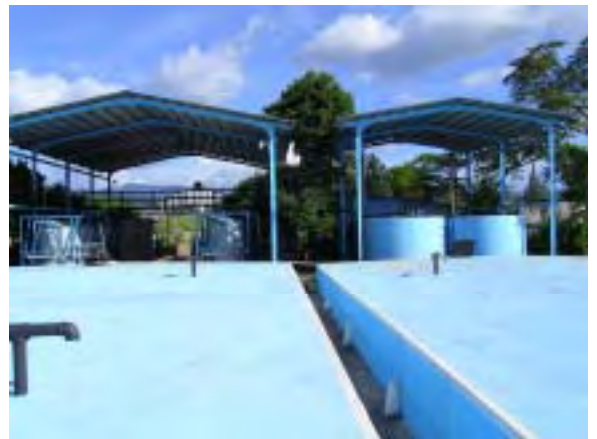
Planta de Tratamiento Miraflores
