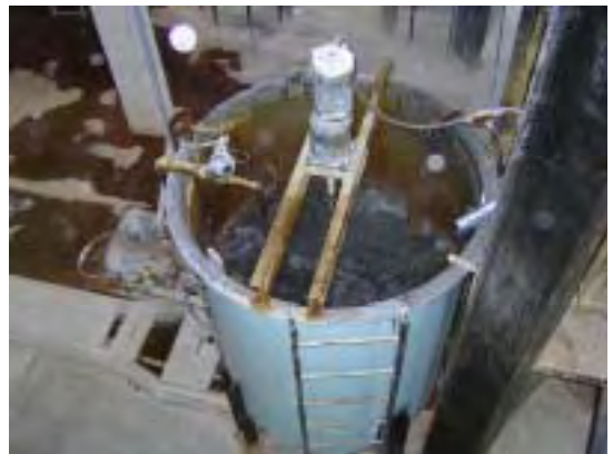
Planta de Tratamiento Picacho ( agitador)
